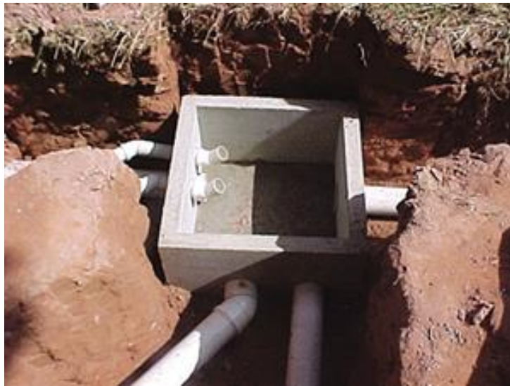
Figura 19 – Detalhe da instalação de uma Caixa de Passagem/ Inspeção propostas pela AGEDOCE
